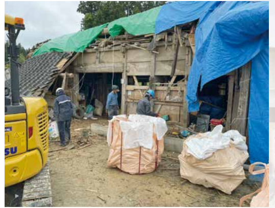
倒壊した家屋にはブルーシートがかけられ、安全に配慮しながら家財の運び出し、災害こみの分別等を実施（令和6年5月撮影）。
